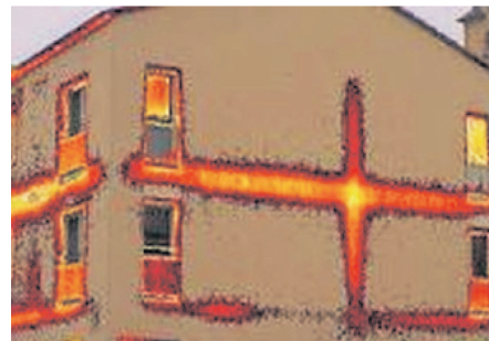
Con una termografía del edificio, se identifican claramente los puentes térmicos del mismo.
